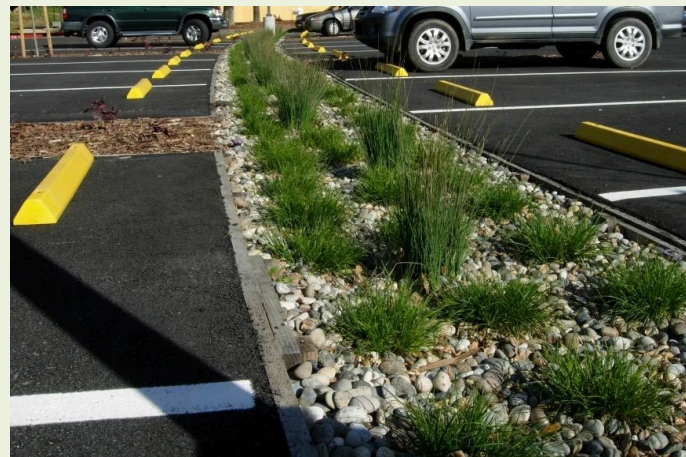
Sumidero filtrante en un aparcamiento. Bordillos enrasados para que el agua pluvial de escorrentía vierta al sumidero. Fuente: SUDS S.L - Atlantis.
