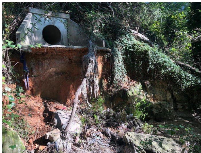
Contaminación asociada a un punto de vertido por desbordamiento del Sistema de Saneamiento (PVDSS) en episodios de lluvia. Fuente: Tecnoconverting.
